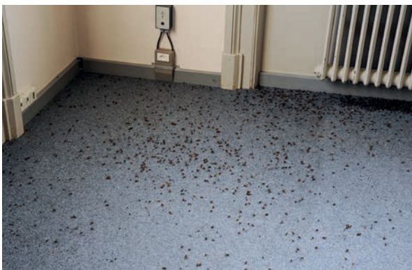
Fliegen- und Wespenbefall (jährlich in diesem Lager- raum vorzufinden)
